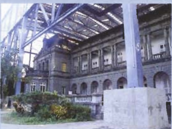
Das National Guest House in Taipeh (Taiwan) wurde mittels eines CKW-freien Abbeizers von seinen alten Farbschichten befreit.
